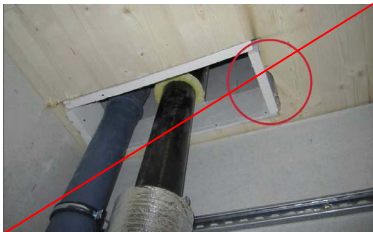
Abbildung 80: fehlerhafte Ausführung: Nicht vollflächiger Einbau der Leibungsverkleidung
